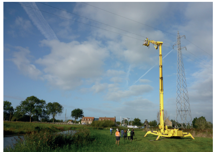
Figuur 8. Het bevestigen van markeringen is logistiek vaak een uitdaging. In Noordschote (W) werd gebruikgemaakt van een hoogtewerker. 04/10/2019.
