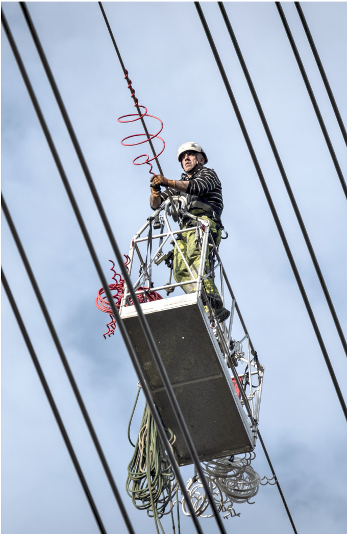
» Figuur 1. Door een luchtlijn te voorzien van markeringen wordt die beter zichtbaar voor vogels. Er bestaan heel wat types van markeringen. Op de luchtlijn Stevin tussen Zeebrugge (W) en Dudzele (W) werd in 2016 de aardkabel bebakend over een afstand van 9 kilometer met grote witte en rode 'vogelkrullen' of 'varkensstaarten'. 16/12/2016. (© Elia)
