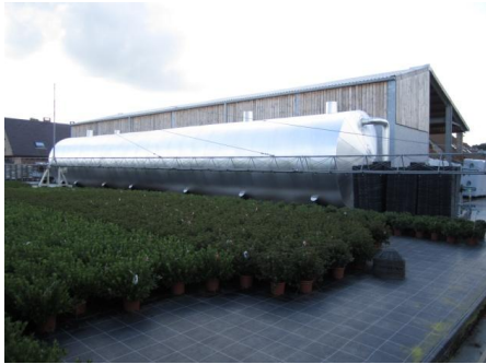
Figuur 5: Om ervoor te zorgen dat steeds aan de warmtevraag kan voldaan worden werd een buffertank van 230m 3 geïnstalleerd.
