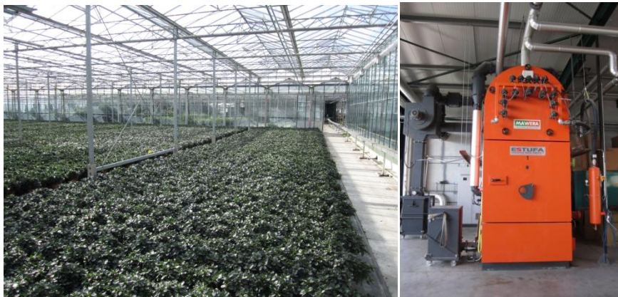
Figuur 1: 3 ha serre worden verwarmd met een vlakroosterverbrandingssysteem van 700Kw.
