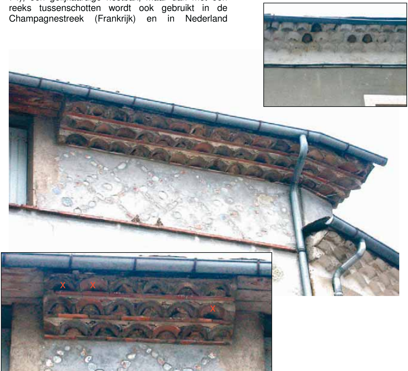
Figuur 73. Speciale, druk bewoonde huiszwaluwappartementen (enkel de kruisjes zijn lege plaatsen in de inzetfiguur) die aan veel huizen als “gevelversiering” aangebracht worden (Florac, Lozère, Frankrijk).
