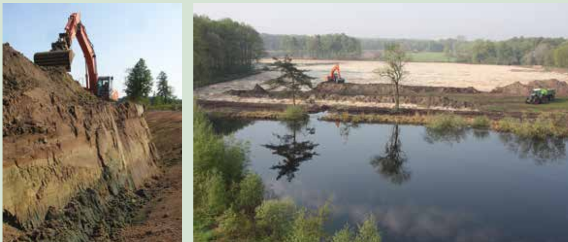
Na chemische bodemanalyses wordt de benodigde te ontgronden diepte bepaald. Dit is, afhankelijk van het natuurdoeltype, vaak dieper dan de bouwvoor (0 tot 30 cm). Om een hectare voor 50 cm te ontgronden is een grondverzet van 5.000 m 3 of ca. 170 vrachtwagens nodig. Links: natuurinrichting van het Europese Life-project 'Averbode Bos en Heide' waarbinnen historische vencomplexen en heide hersteld werden op o.a. voormalige maïsakkers (foto: VLM); rechts: grootschalige natuurinrichting in het Turnhouts Vennengebied waar in 2011 voormalige landbouwterreinen ontgrond werden (foto: Mario De Block).
