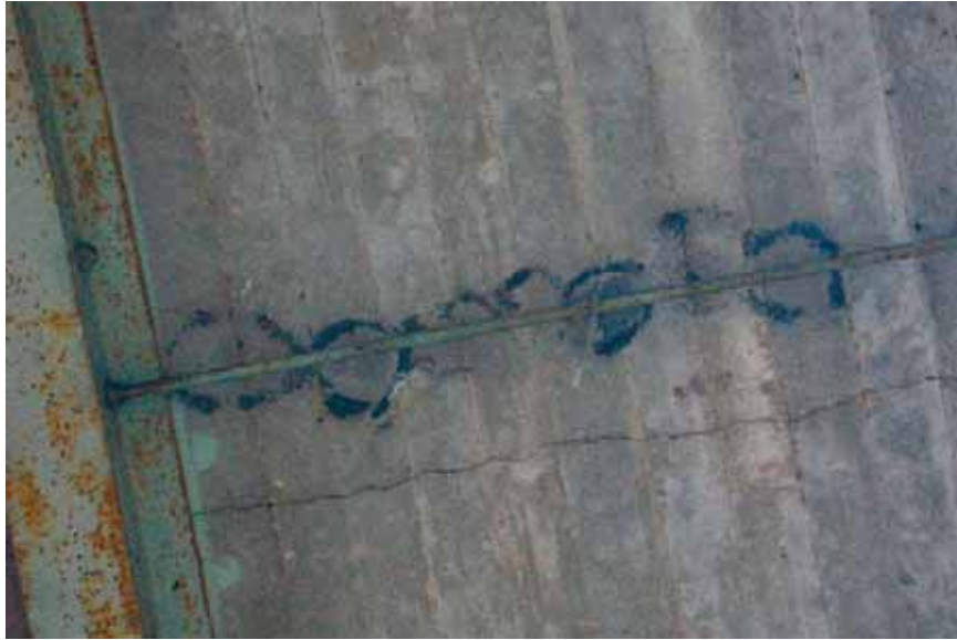
Figuur 17. Sommige vogels slagen er op onwaarschijnlijke manier in om vanaf een steunpunt een nest te bouwen. Getuigen uit een (ver ?) verleden: op het plafond afgetekende ringen in zwart mijnstof van een reeks nesten die vanaf een relatief dunne metalen staaf werden opgebouwd onder een open hangard (Heusden-Zolder, mijnsite).
