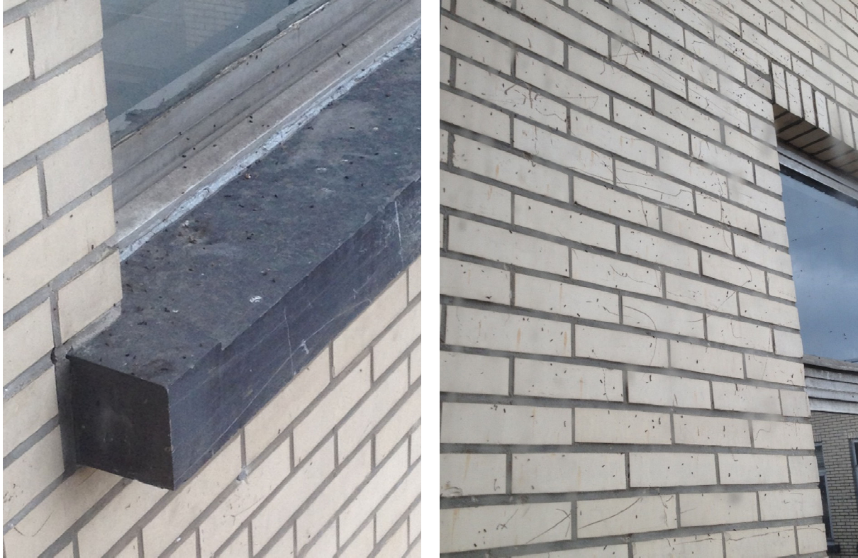
Figuur 7. Uitwerpselen van vleermuizen op vensterbanken en tegen de muur op de binnenplaats van het kantoorgebouw (26 september 2020)
